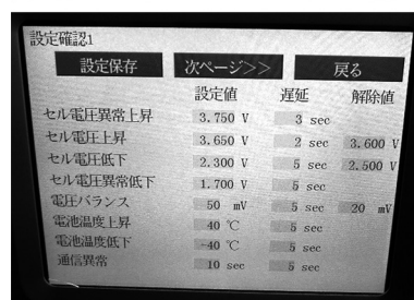
図4：BMS液晶モニター
